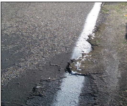
(e) Cracked Pavement Edge (LA 354)
