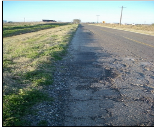
(b) Cracks (LA 1113)
