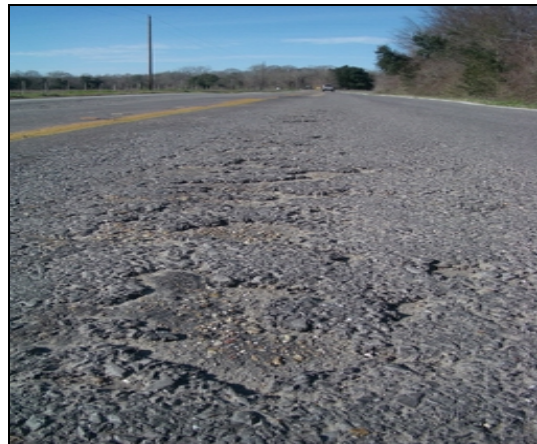
(d) Deteriorated Overlay (LA 354)
