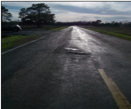
(c) Pothole (LA 354)
